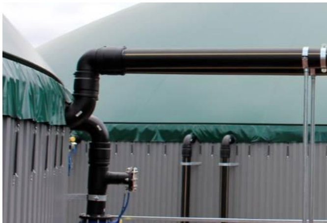
Canalisation de biogaz
