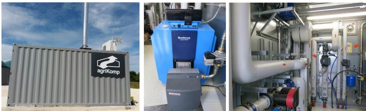
Chaudière biogaz en container
